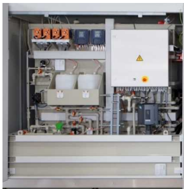
図5 電解液タンク内部
